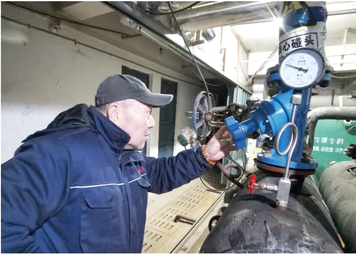
福临花园小区换热站工作人员查看供热设备。
