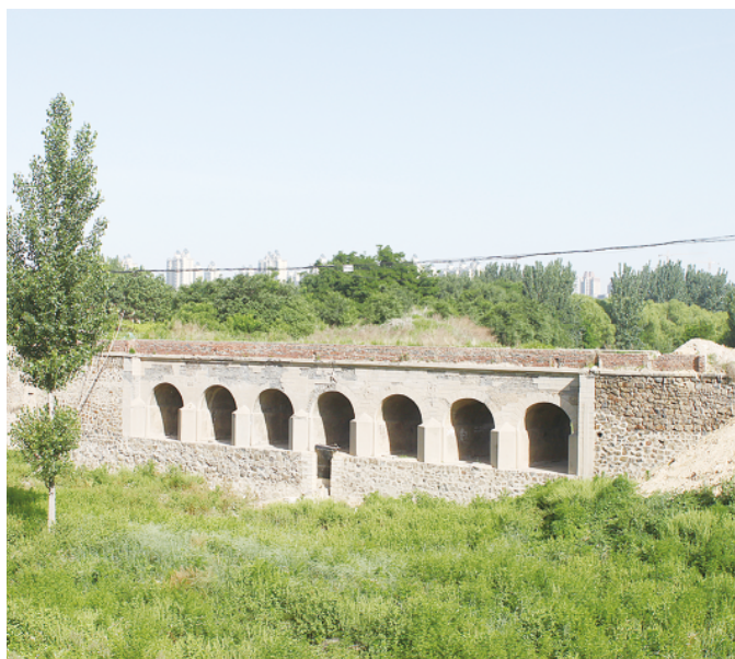
已经废弃的张面河“丁马水库”桥坝。（摄于2018年）
