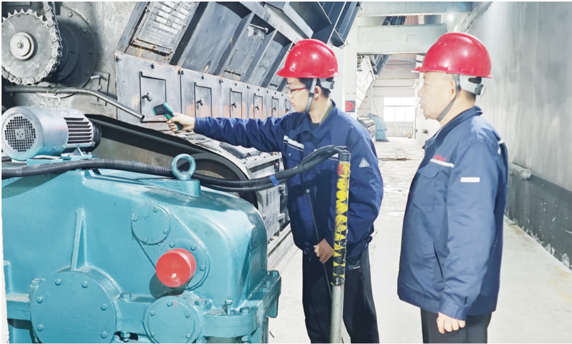
潍坊市热力有限公司工作人员在检查供热设备运行情况。
