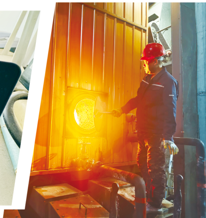
潍坊市热力有限公司西部热源厂的工作人员查看锅炉燃烧情况。
