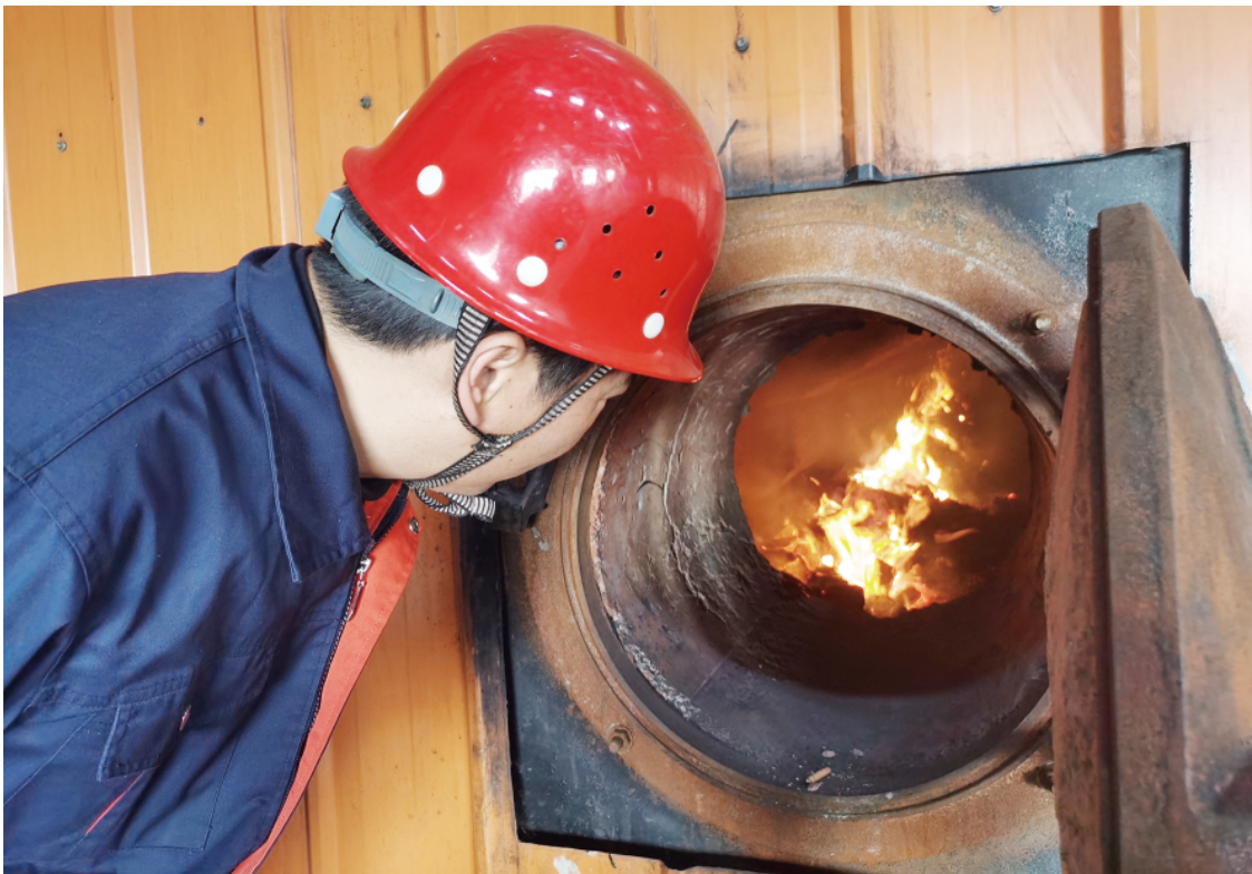
工作人员查看锅炉燃烧情况。
