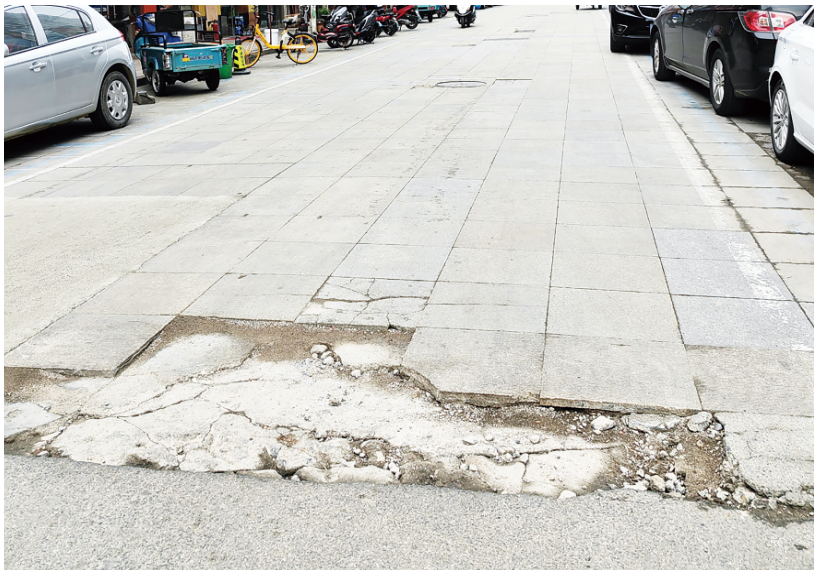
►通济门街地面砖缺失，路面坑洼不平。
