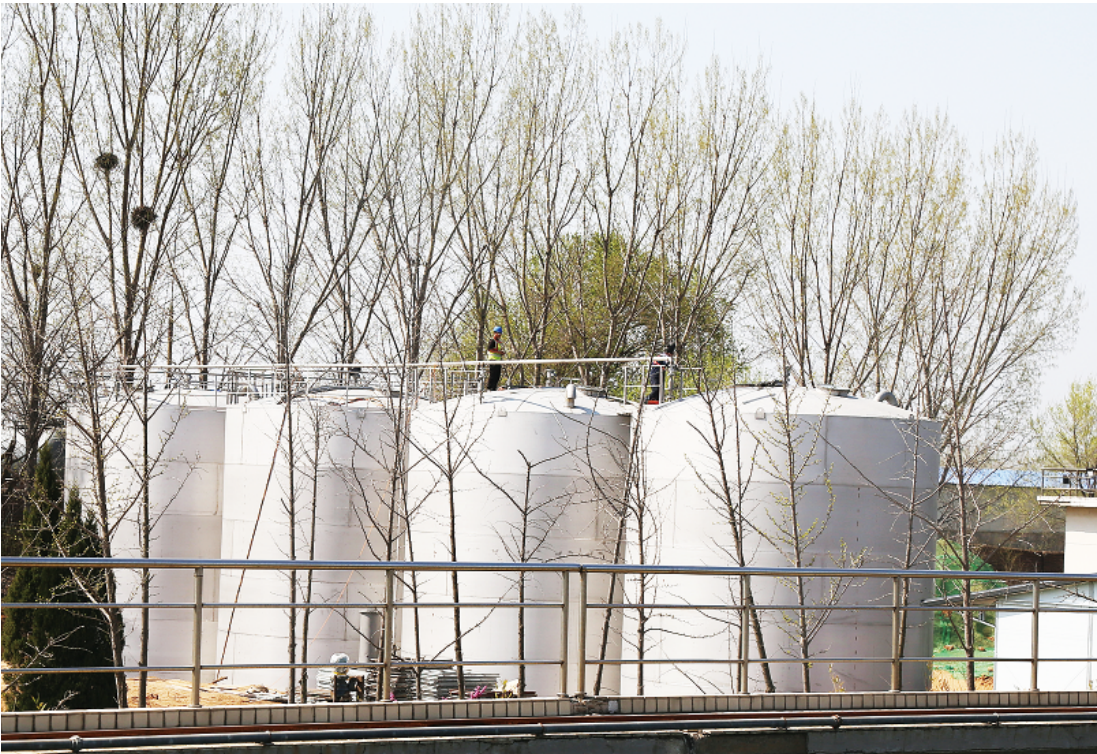
白浪河水厂处理水质用的臭氧接触罐。
