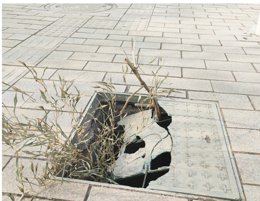
经济区吉庆街新华路口西南侧人行道上破损的井盖。
