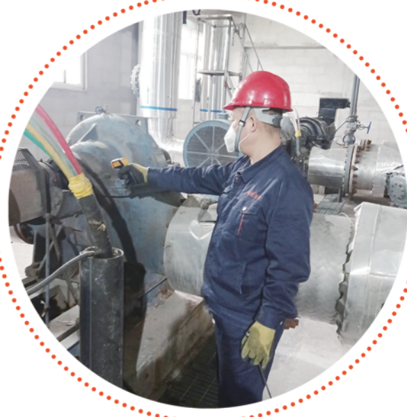
潍坊市热力有限公司热源厂工作人员巡检供热设施。
