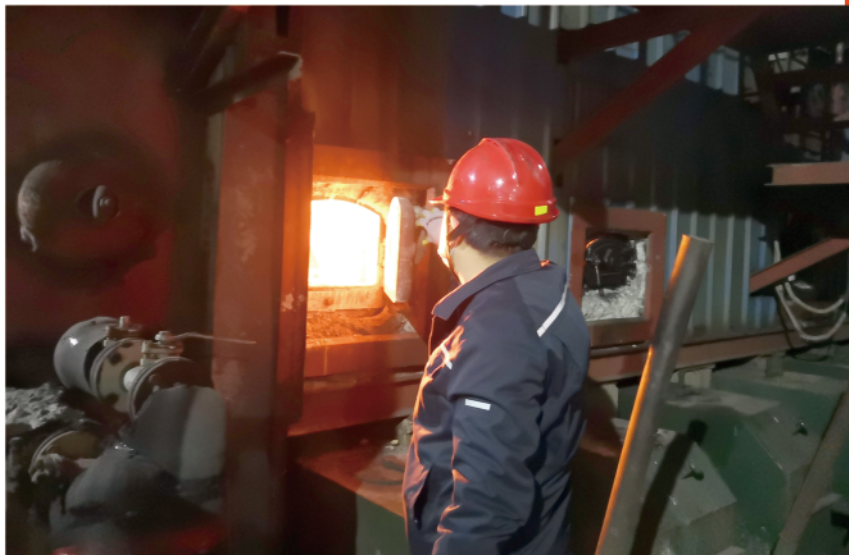
市热力有限公司热源厂内,工作人员正在查看锅炉运行情况。
