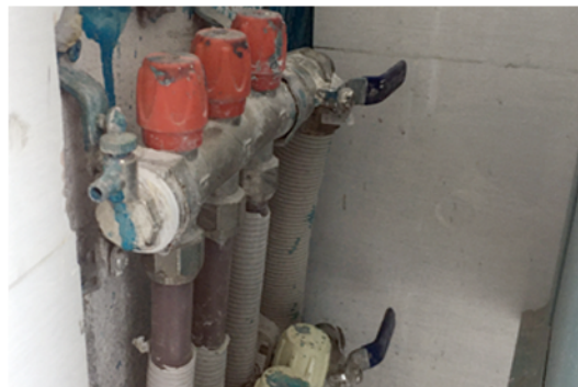
和润·海棠湾小区郭女士家阁楼上供暖设施。
