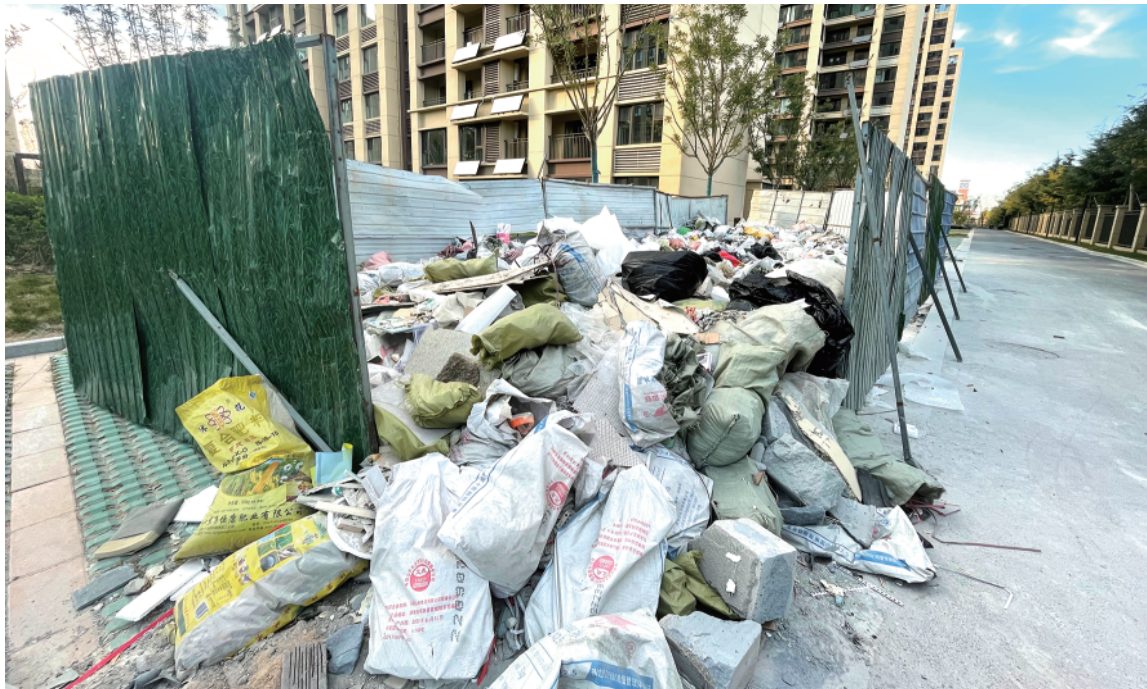
9号楼东两侧的渣滓池内堆积着很多垃圾。
