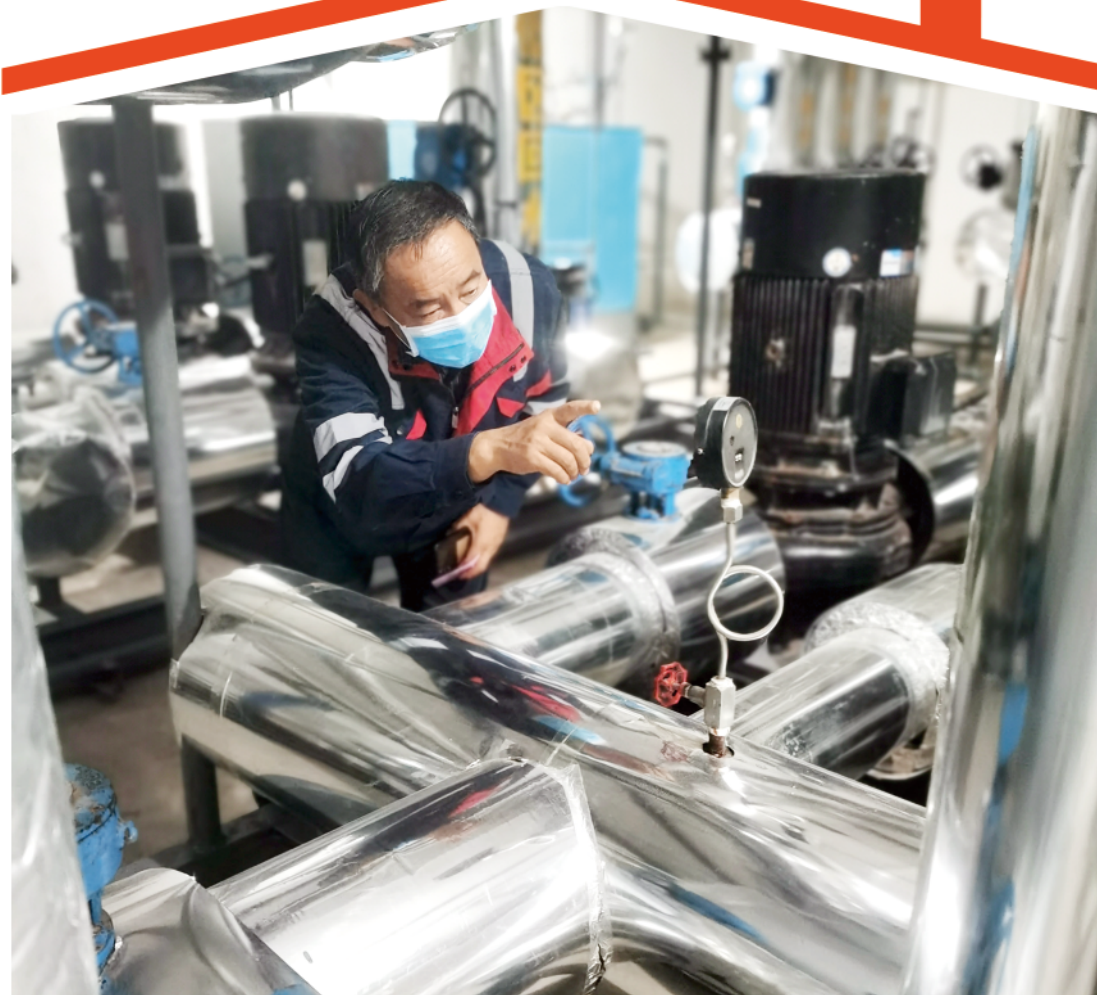
高新区北斗山河城小区换热站内，潍坊五岳热力有限公司的工作人员在巡检。
