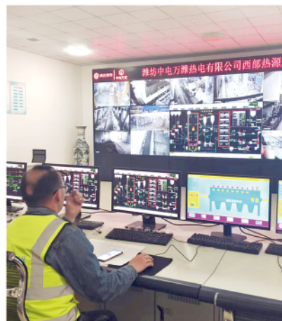
潍坊中电万潍热电有限公司西部热源厂锅炉控制室内，工作人员正通过控制系统查看锅炉运行情况。
