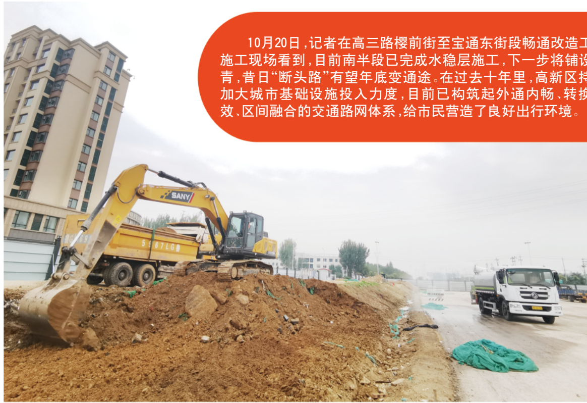
高三路樱前街至宝通东街段正在进行道路畅通改造施工。
