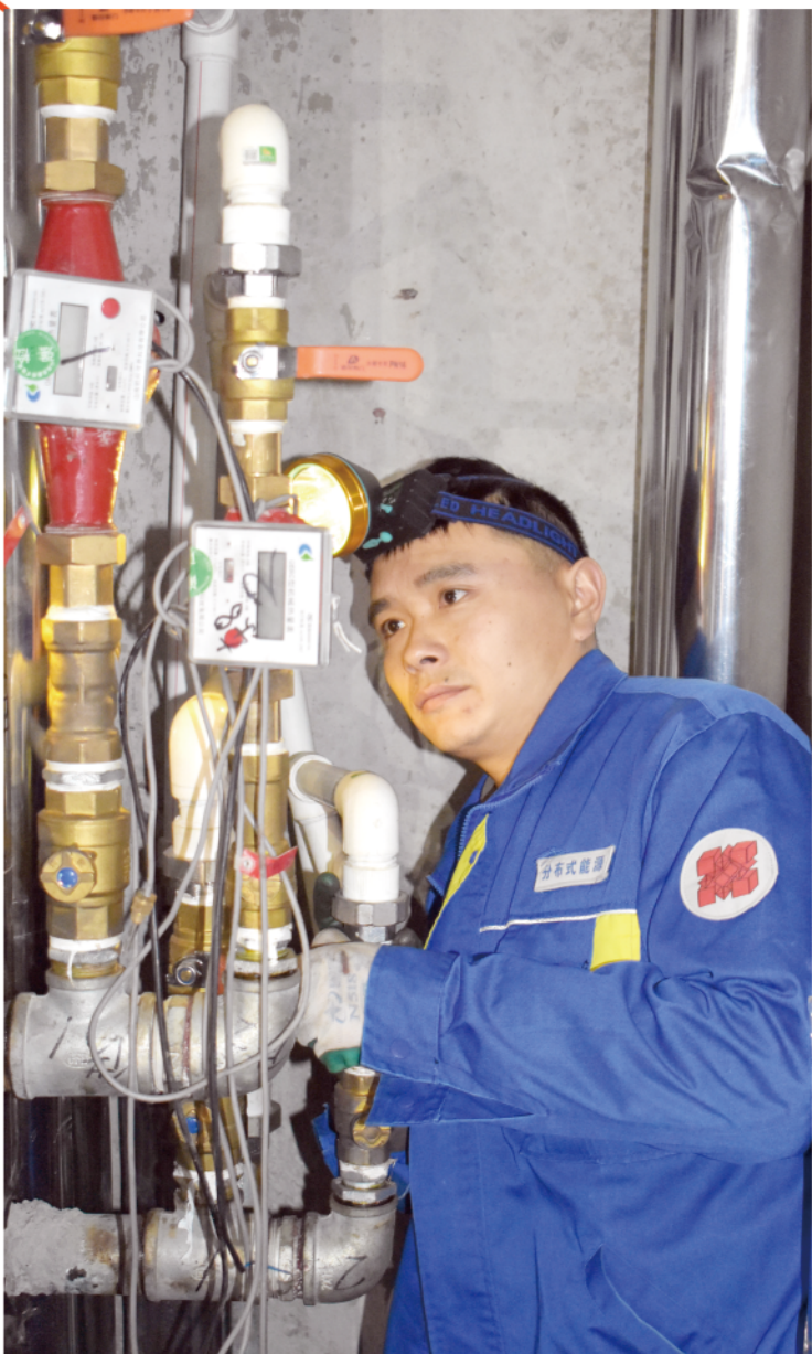
中环寰慧(潍坊)节能热力有限公司的工作人员在换热站巡检。
